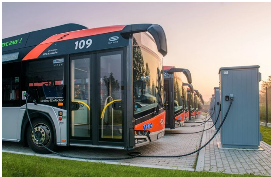
Rys. 12. Infrastruktura do ładowania pojazdów marki Solaris Urbino 12 na zajezdni w Rzeszowie
